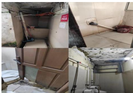
Gambar 2. Kondisi Toilet Umum Jam Gadang
